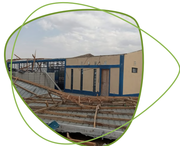
Dach liegt am Boden nach heftigem Sturm
